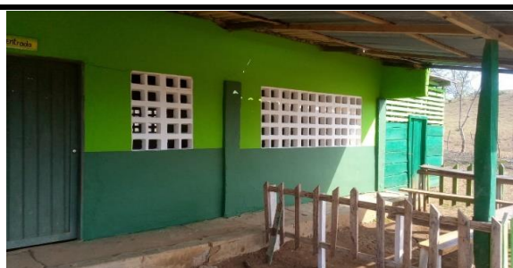
de almacenamiento con sikatop 107. Se cambiaron algunas varetas del cercado perimetral y se instalo una puerta metalica.
