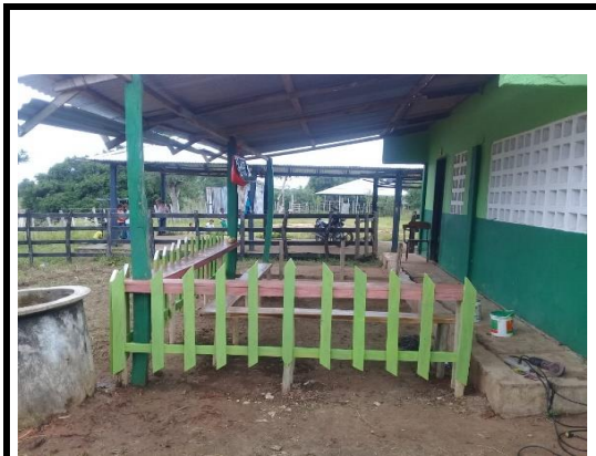
Pintura del comedor de madera se cambiaron varetas al cercado existente. Sede Buenaventura
