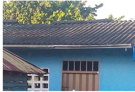
Arreglo de cubierta , incluye instalacion de caballetes en la sede Arroyo Arena
