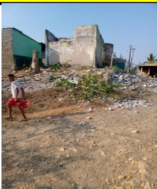
Unidad sanitaria a demoler por agrietamientos y posible siniestro. Sede Villa Esther
