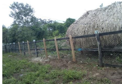
Se aprecia los postes y varetas que se cambiaron en el cercado perimetral de la sede El Libano.
