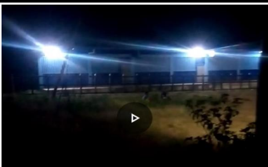
Vista sede el Libano de noche, se aprecian los reflectores instalados.
