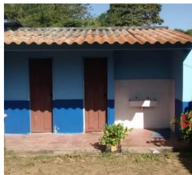
Estado Actual unidad sanitaria sede Providencia.
