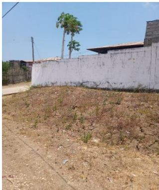
Muro a demoler por posible siniestro. Sede Villa Esther
