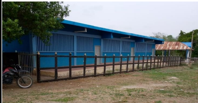
Arreglo del cercado y Mantenimiento de pintura externa tipo 1 sede El Libano. Tambien se desmote y fumigo la maleza.
