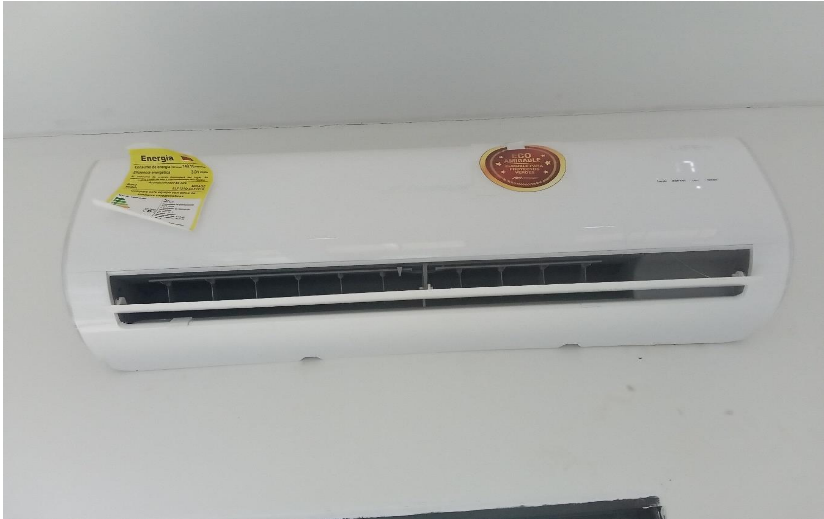
Aire acondicionado instalado en la sala de informática – sede principal
