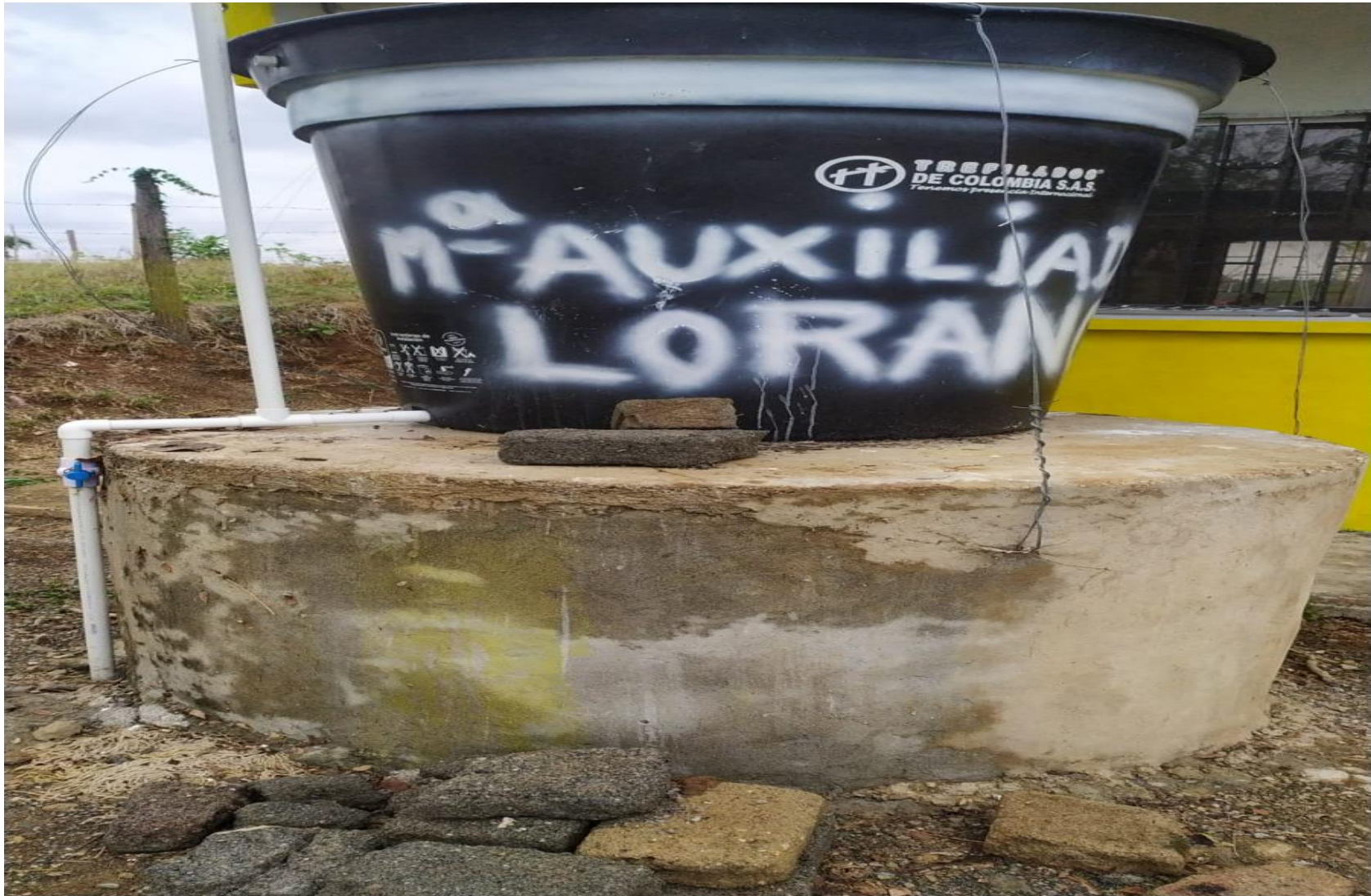
Tanque elevado y tubería para sanitarios en la sede María Auxiliadora
