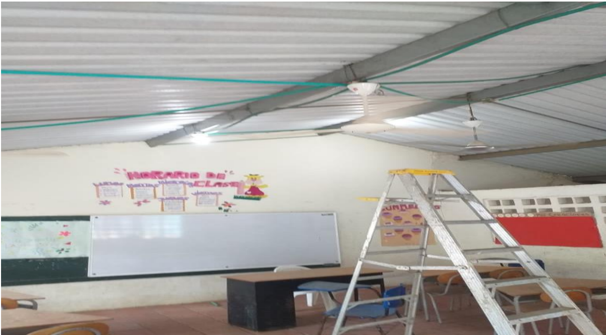
Mantenimiento Eléctrico e Eliminación por robo, Cedro
