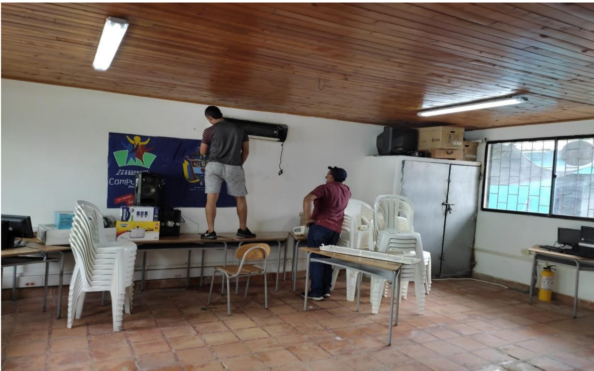
Mantenimiento y arreglo de aire acondicionado por Daño, sala de informática zapal
