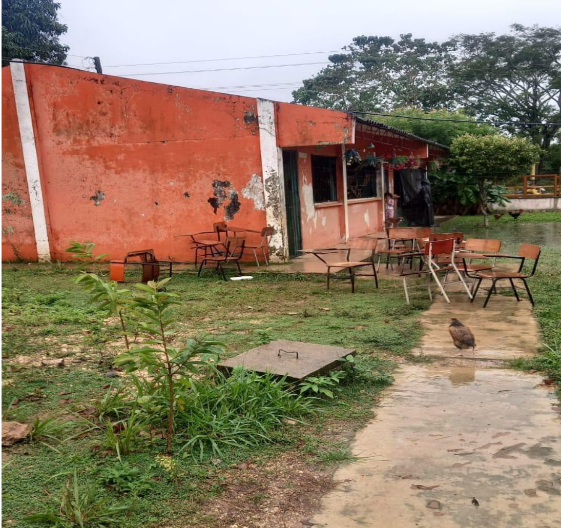
DETERIORO MUEBLES ESCOLARES BAJO LA LLUVIA
