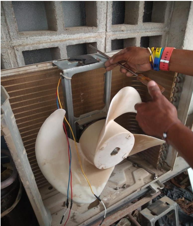
Mantenimiento de los 5 minisplits
