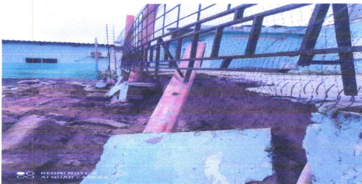
Imagen 2; derrumbe muro durante la ejecución de la obra, ubicado exactamente al lado donde se construirá el muro de un aula de clases.
