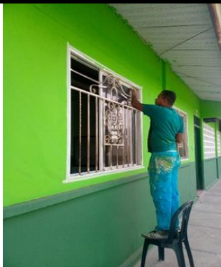
Mantenimiento corrosion de ventanas
